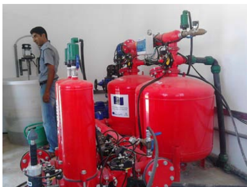
Tunisie – Site pilote réalisé par le projet ACCBAT pour l'irrigation avec les EUT du centre arboricole de la Station Expérimentale de l'IRGREF à Oued Souhil.
